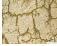
So sieht „kranker“ Beton aus.
